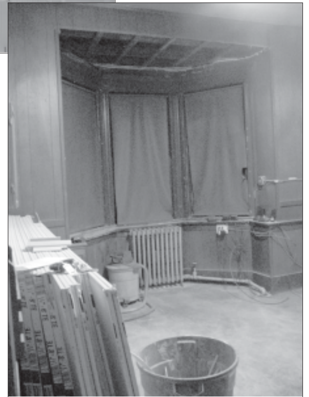
Durante todo este tiempo, los muebles han estado almacenados en otras habitaciones en espera de completar las reparaciones. Observe el techo por donde entra el agua cuando llueve.
