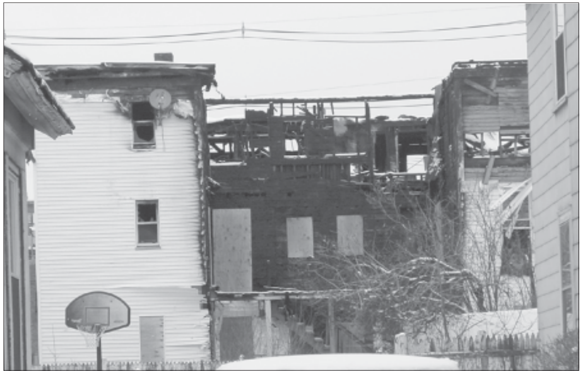
Las condiciones en que quedó el edificio del 48-50 de la Calle Manchester por la parte de atrás donde comenzó el fuego catalogado como intencional.
